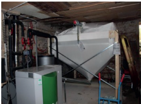
Chaudière à granulés et silo. Source : Effilogis
